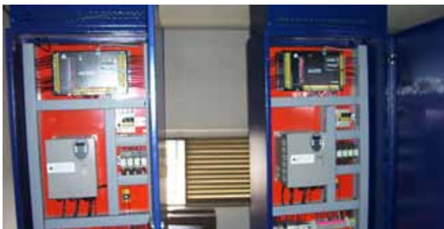
Sala de máquinas - Nuevos equipos de control de ascensores
