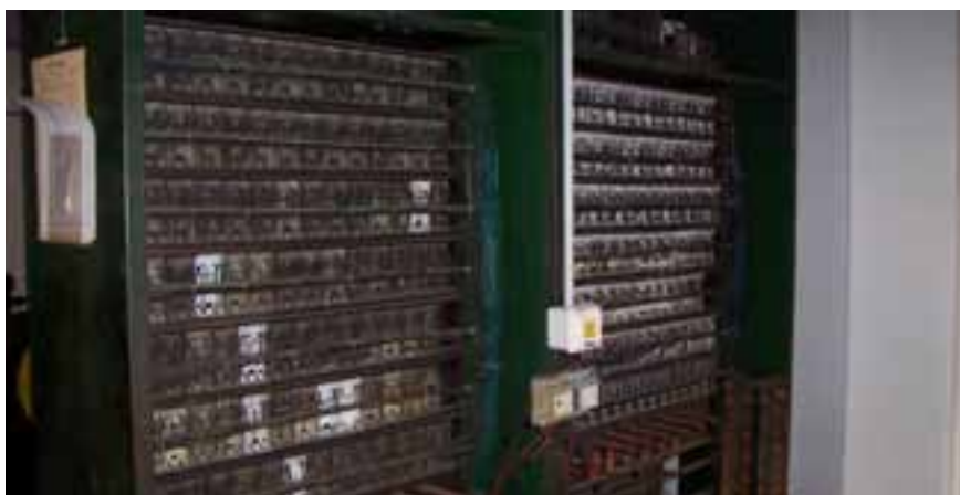
Sala de máquinas - Antiguos equipos de control de ascensores
