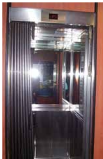
Ascensor Sede Central
